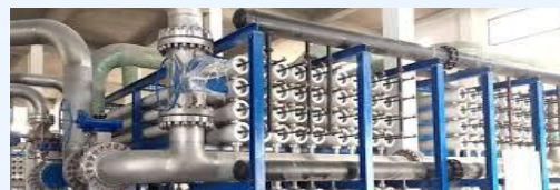
Financement de la Station de Dessalement Grand Casablanca
